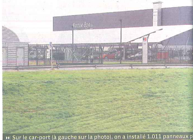
► Sur le car-port (à gauche sur la photo), on a installé 1.011 panneaux ph
